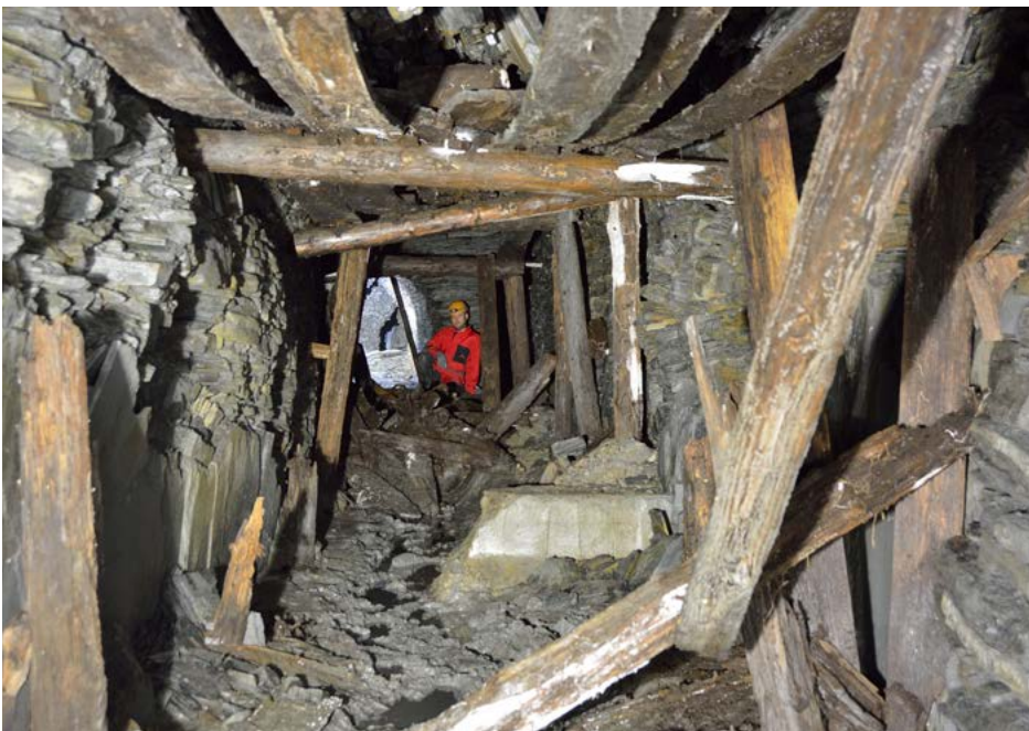
Stará lhotecká štola, Vítkov, Nízký Jeseník | Důlní výdřeva v historickém hornickém díle degraduje a s ní i nezpevněné nadloží, které měla původně stabilizovat | Martin Kašing, 2018.
