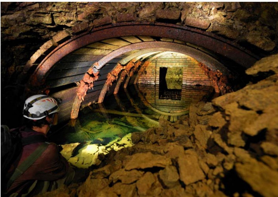
Protiletecký kryt Na Liščině, Slezská Ostrava, Ostravská pánev | K postupné degradaci zdiva a výztuži přispívá pronikající voda – zřejmě v podobě kyselé důlní drenáže | Jan Lenart, 2016.
